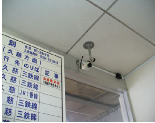
・防犯カメラ設置状況
