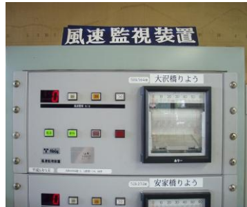
風速監視装置
