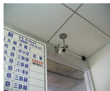
防犯カメラ設置状況
