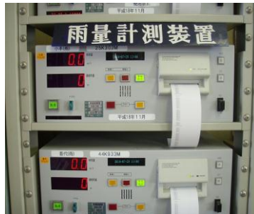
雨量監視装置
