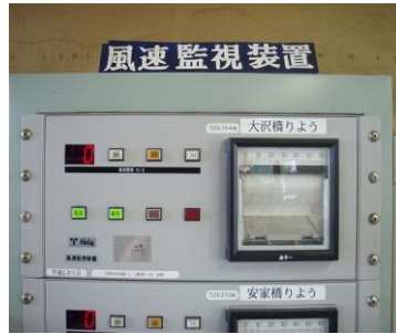
風速監視装置
