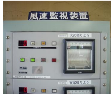
風速監視装置
