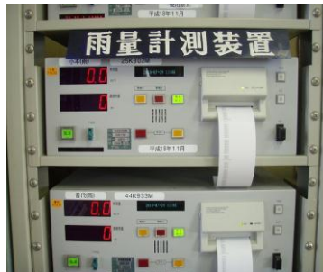
雨量監視装置
