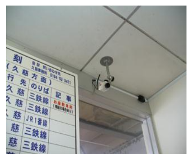
防犯カメラ設置状況
