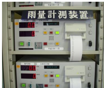
雨量監視装置
