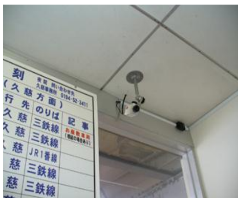
防犯カメラ設置状況
