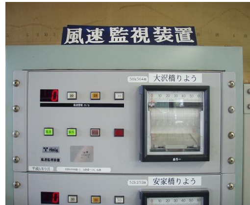
風速監視装置
