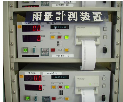
雨量監視装置
