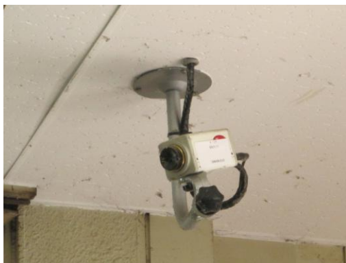
防犯カメラ設置状況
