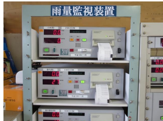
雨量監視装置
