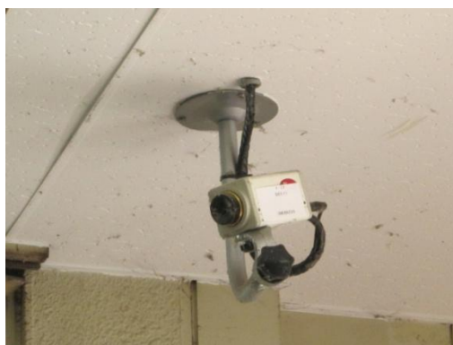
防犯カメラ設置状況
