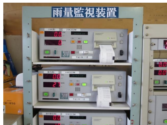
雨量監視装置
