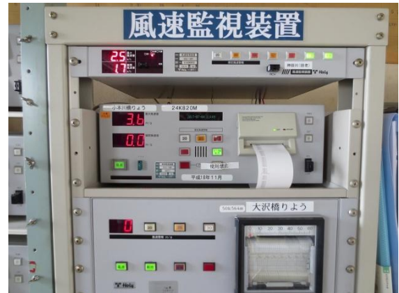
風速監視装置
