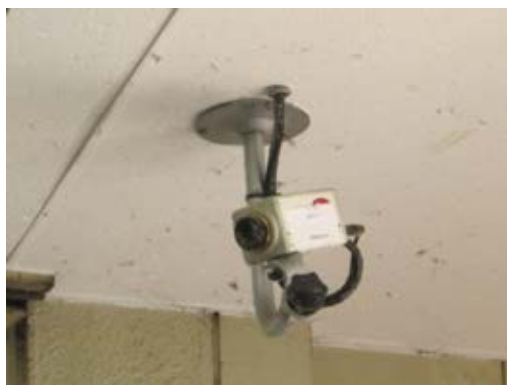
防犯カメラ設置状況
