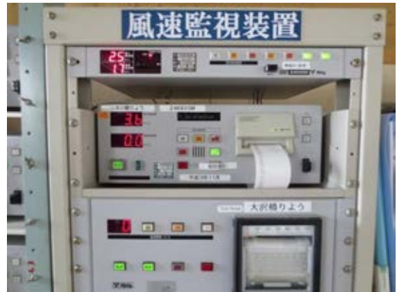
風速監視装置
