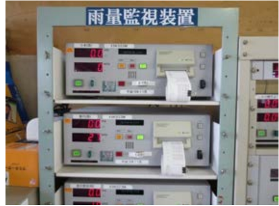
雨量監視装置
